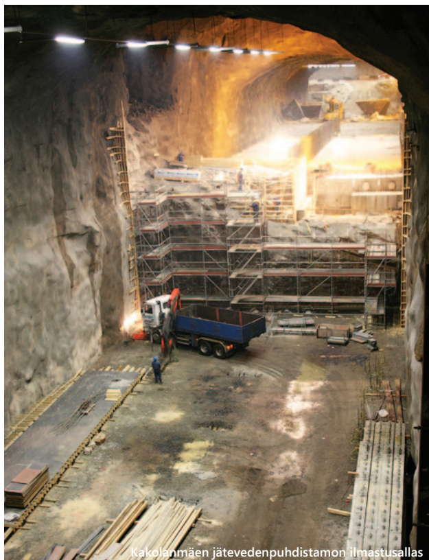
Kakolanmäen jätevedenpuhdistamon ilmastusallas
